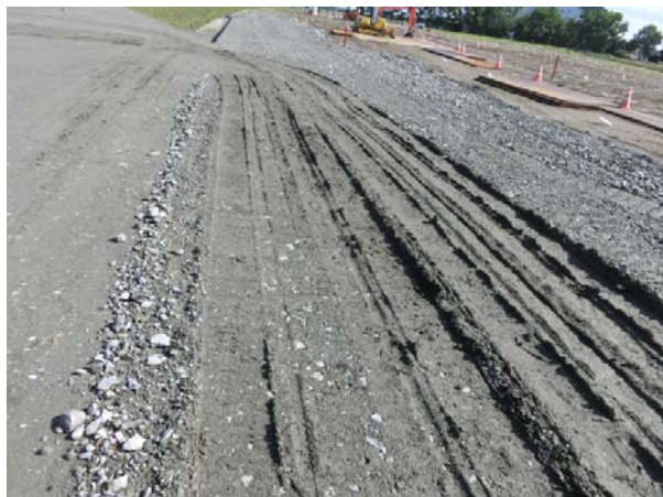
図-10 タイヤローラー走行跡
